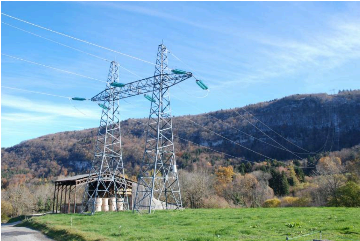
Vue de la ligne à haute tension qui traverse la commune.
