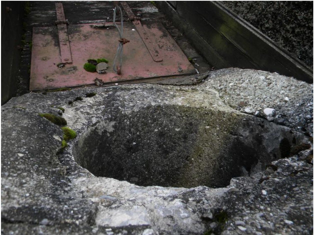
Vue de la sortie de la colonne de décharge du béliet hydraulique au niveau du bief aérien.
