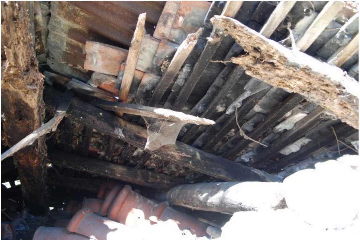
Four à pain, détail de la charpente ruinée.
