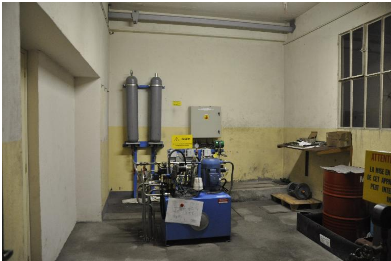
Vue des installations d'une salle
