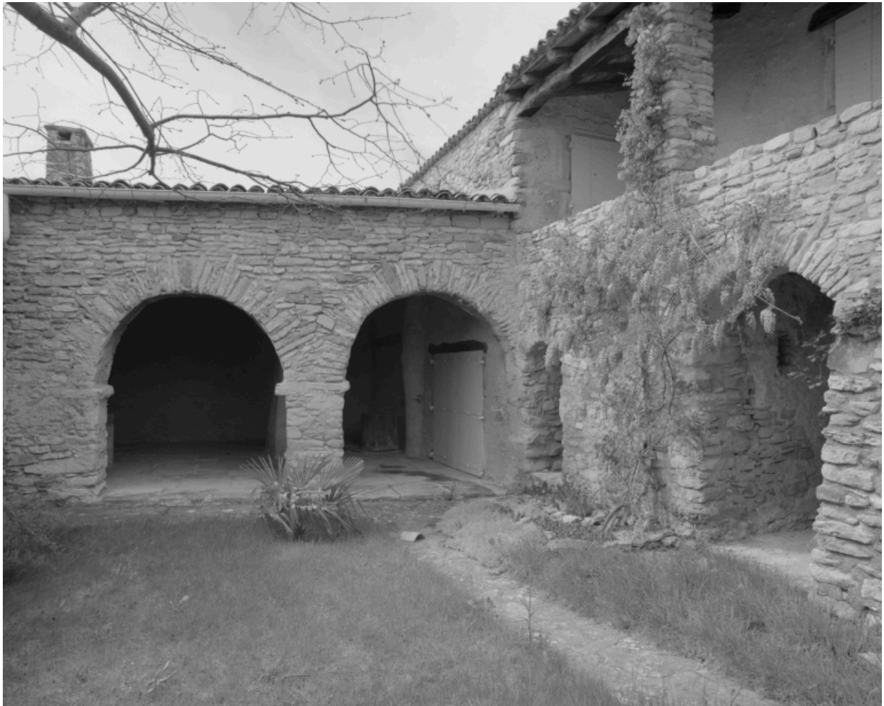
Chèvre, chemin de Taulignan au Poët-Laval. Vue de la galerie depuis la cour, et d'une ancienne dépendance.
