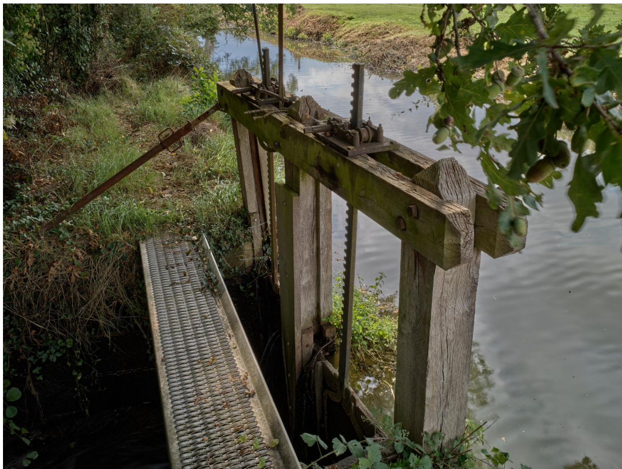
Vue d'une vanne.
