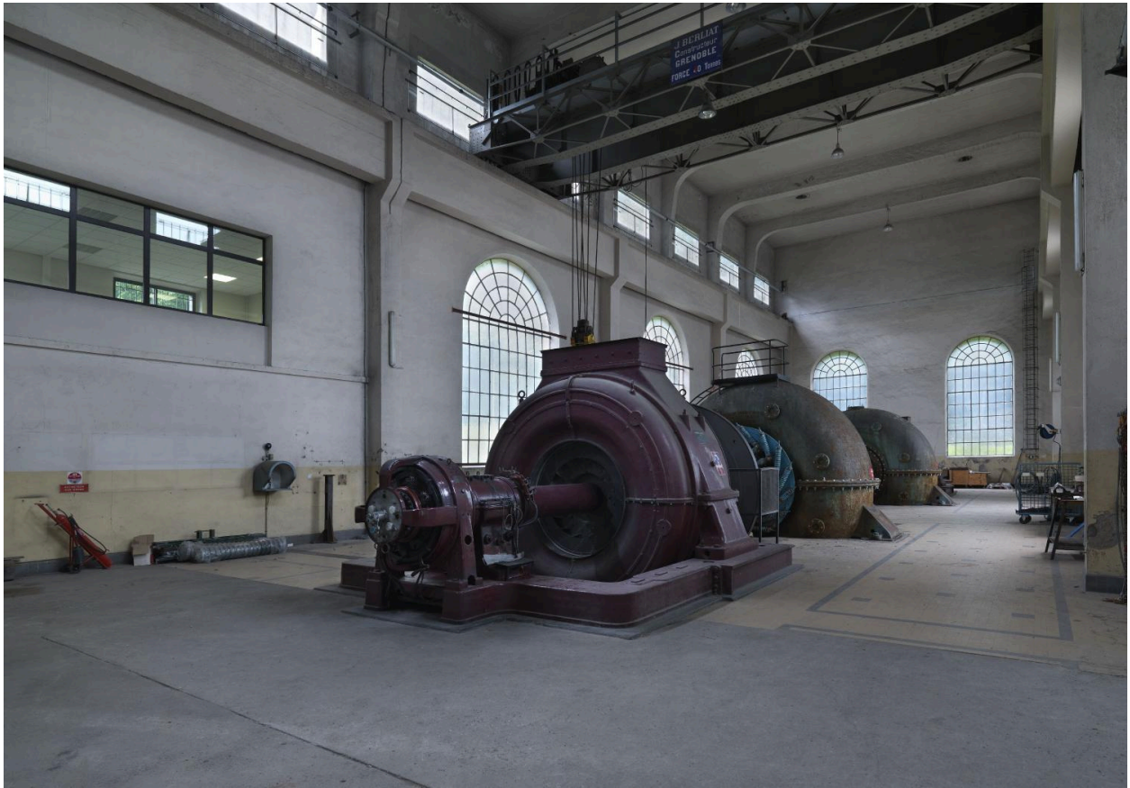
Salle des machines partie groupes horizontaux
