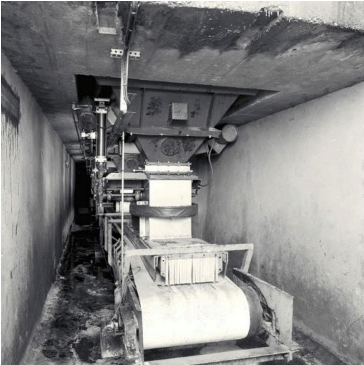
Intérieur des silos : la galerie souterraine du silo ouest, depuis le côté gauche, et le transporteur à bande
