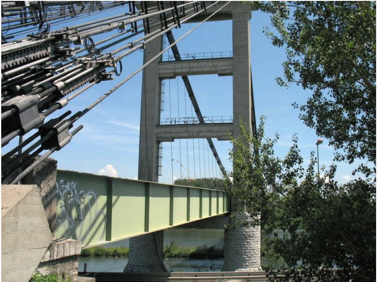
Pylône rive droite et vue partielle du tablier (travée de rive, côté aval)
