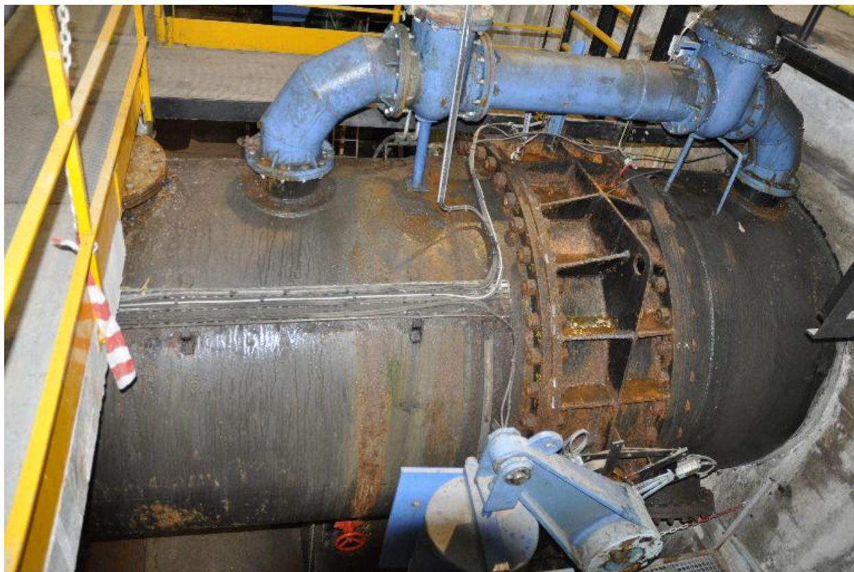
Vue de la turbine d'un groupe verticale
