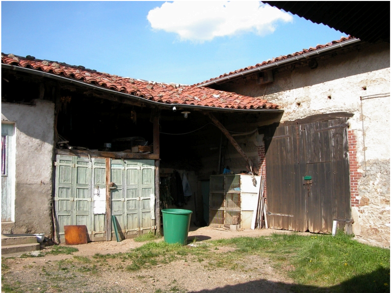
Vue d'ensemble de la remise protégeant l'entrée du cuvage et de la grange.
