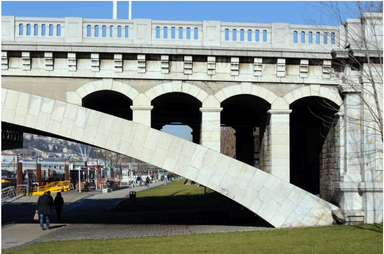
Arche gauche, face aval, vue partielle : ancrage dans le sol et quai (depuis la rive gauche)
