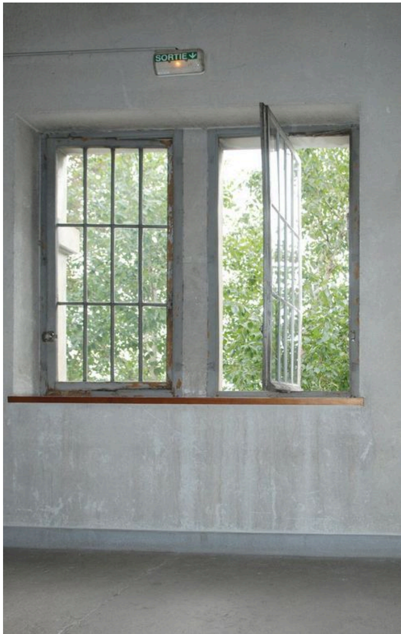
Bâtiment des services généraux, escalier sud, palier entre le premier et le deuxième étage, détail du système d'ouverture pivotant
