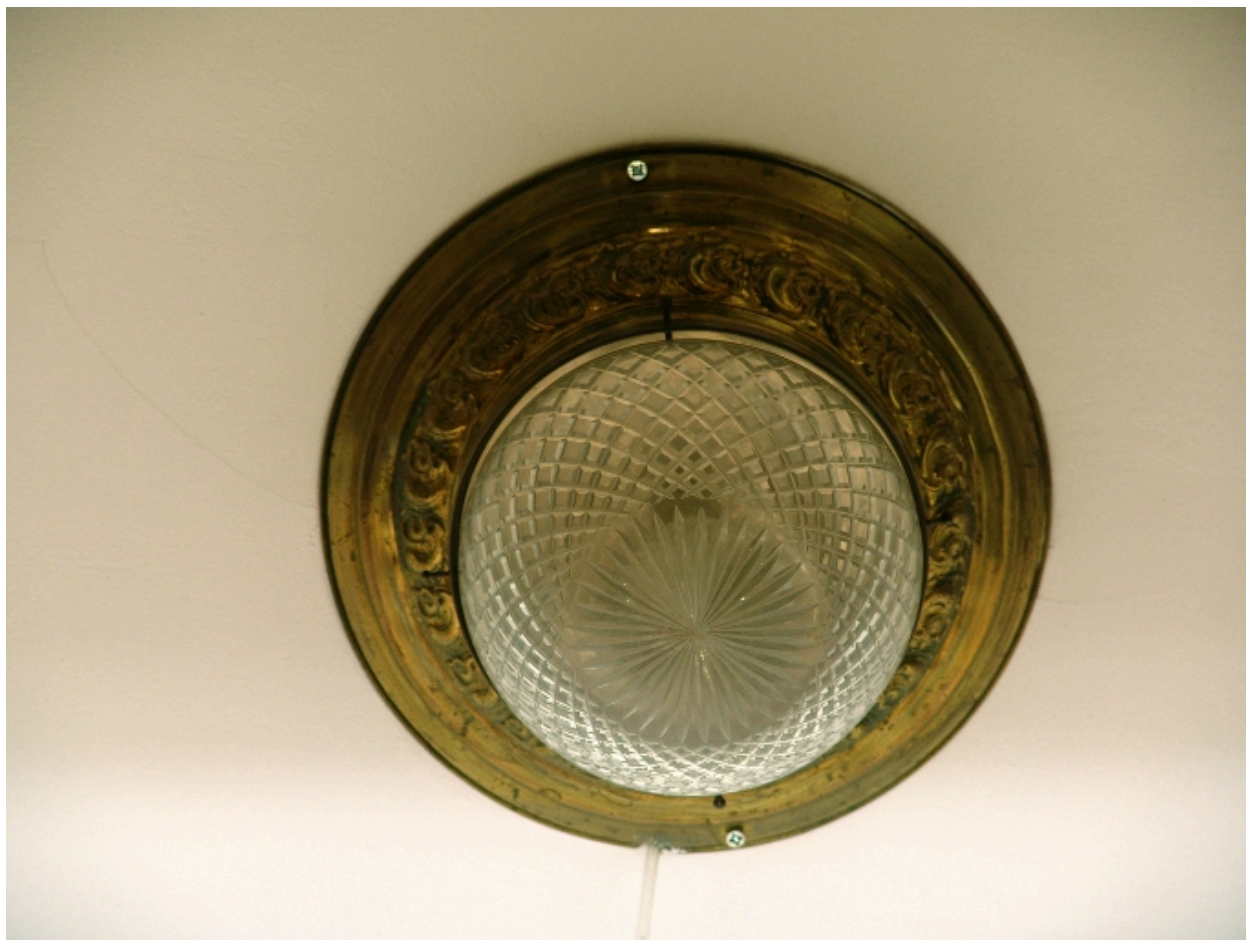
Luminaire du dernier étage, côté est
