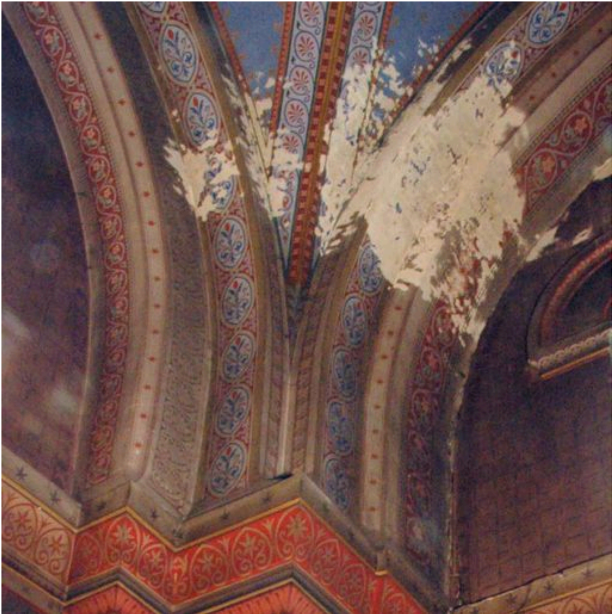
Décor peint, détail des altérations au niveau de la retombée de la voûte, en revers de façade
