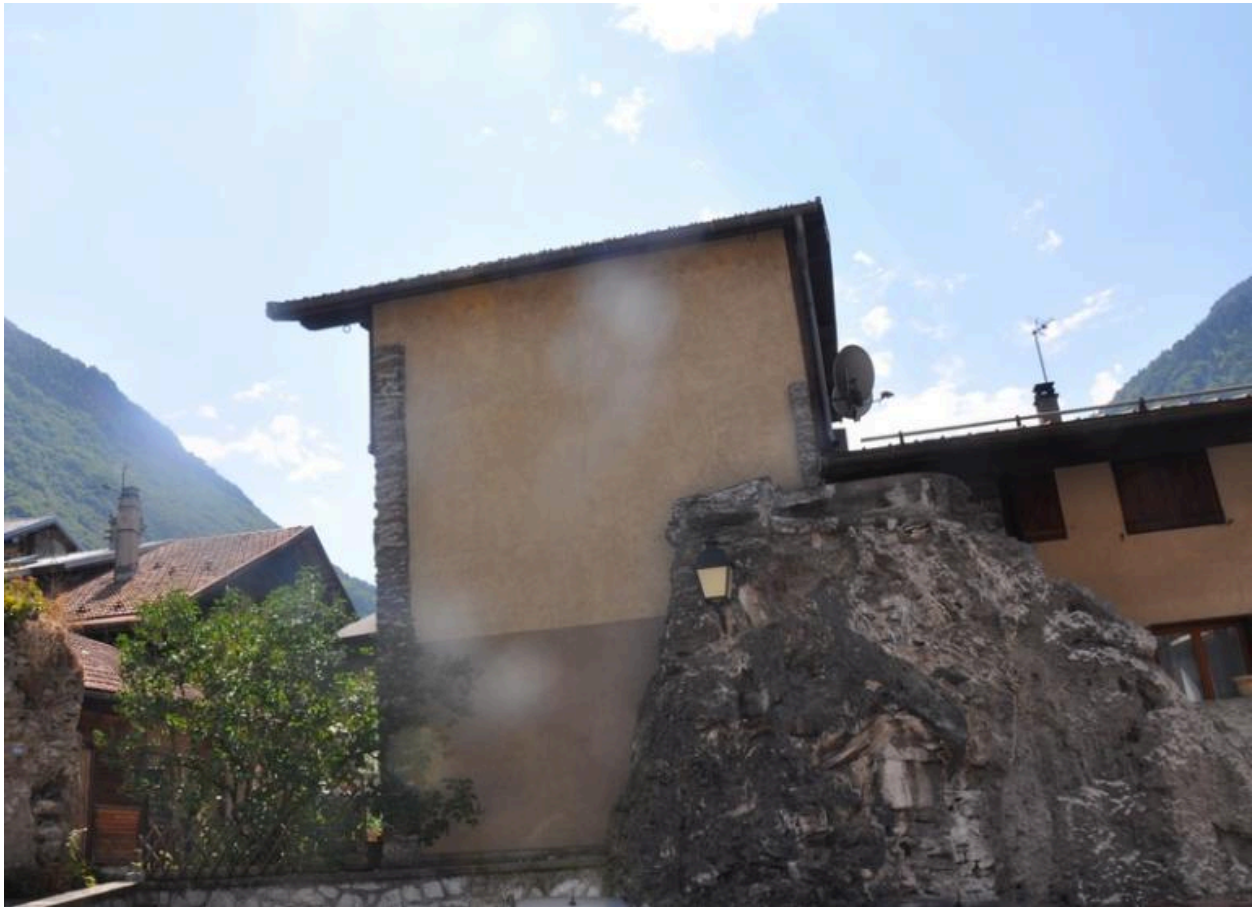
Façade nord de l'ancien moulin-scierie Collomb le long de laquelle passait la dérivation.
