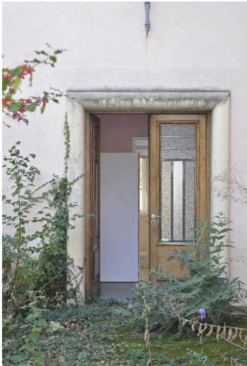
Bâtiment sud, élévation ouest : vue de la porte remaniée au 20e siècle
