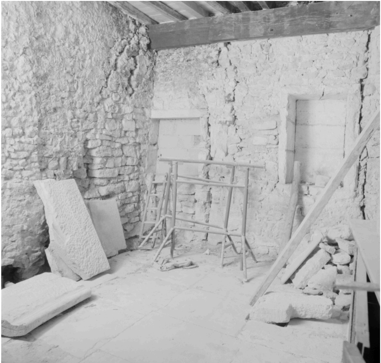
1er étage, corps de bâtiment sud, pièce donnant sur la cour : placard à dalles de pierre.
