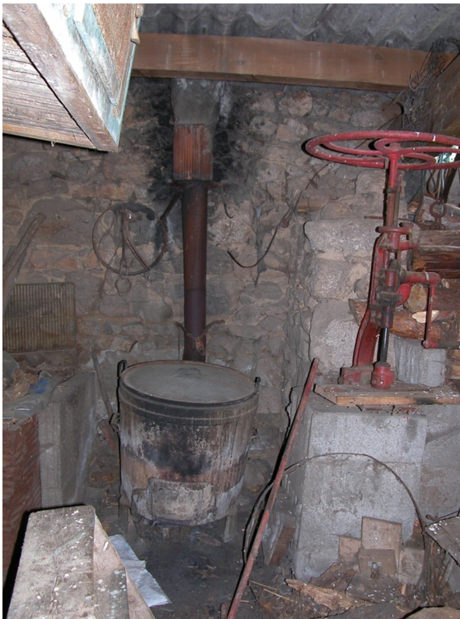
Vue intérieure de la chaudière.
