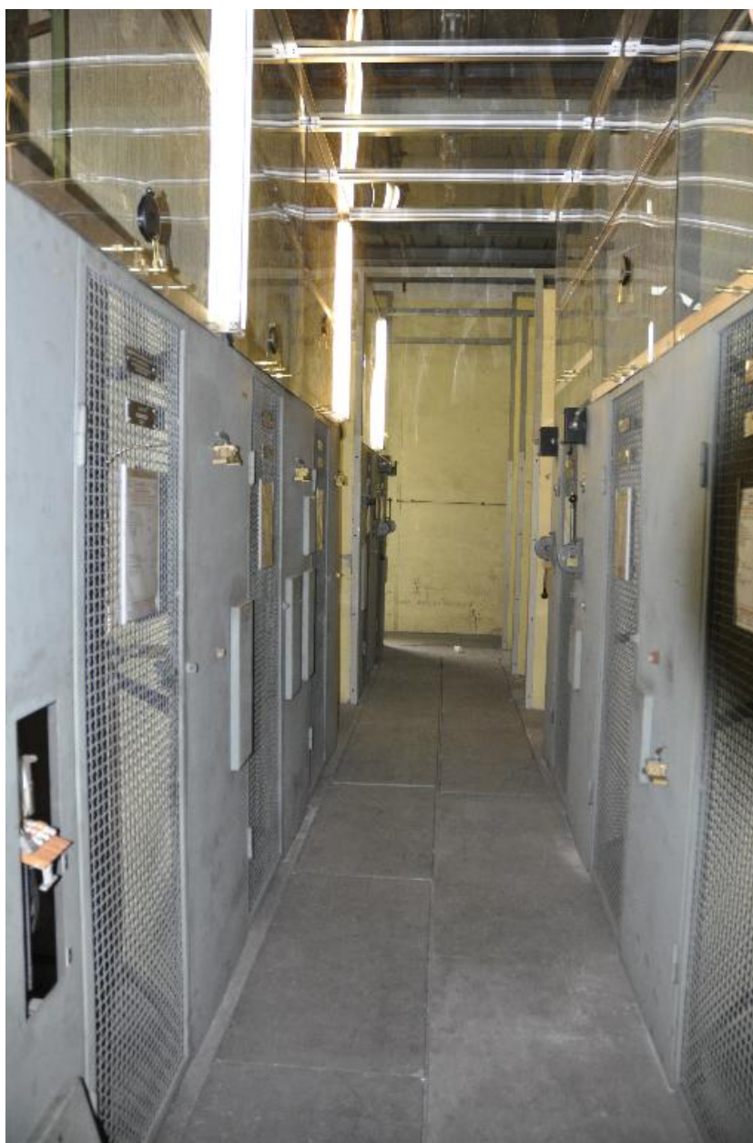
Vue des armoires des transformateurs
