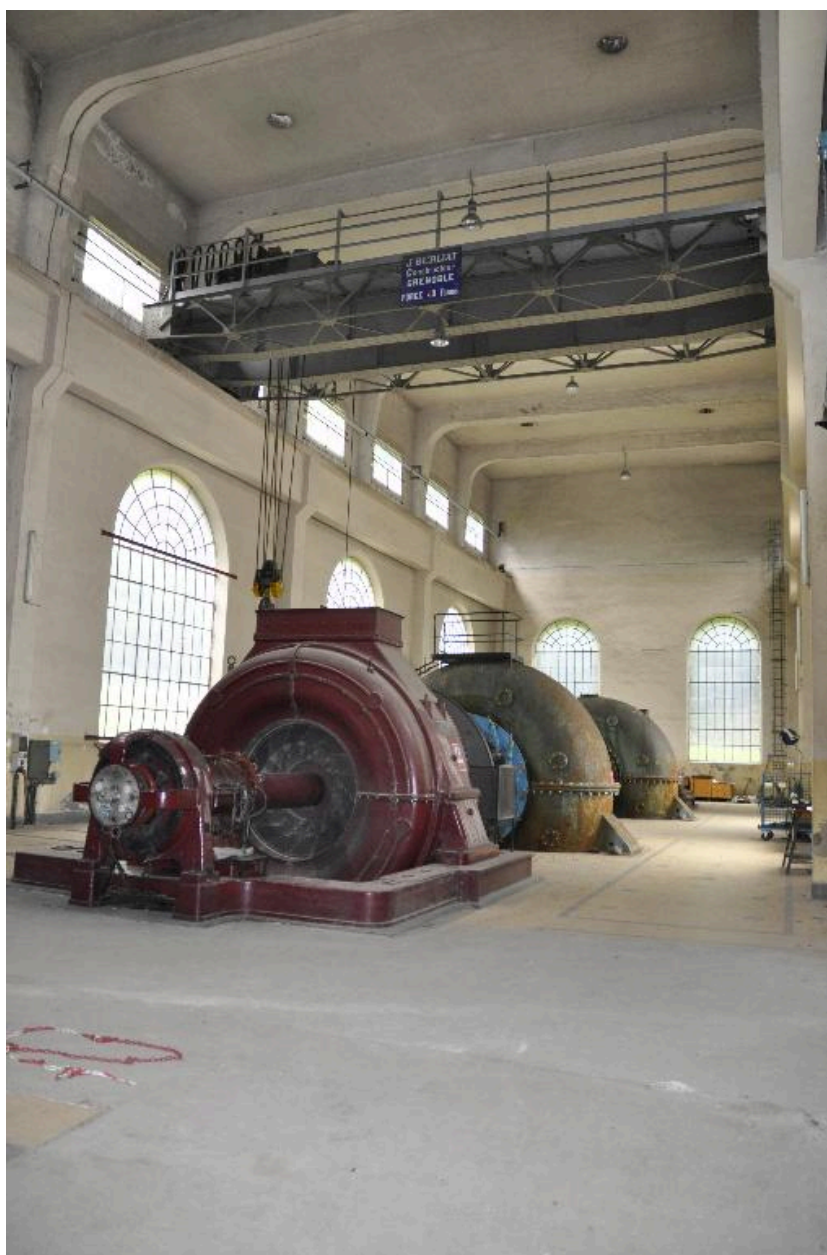
Vue de la salle des machines
