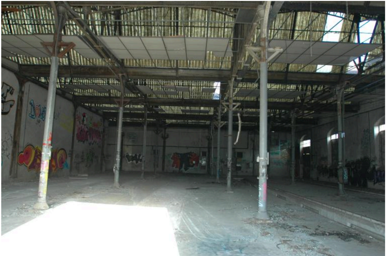
Vue intérieur des atelier Oullins-voitures
