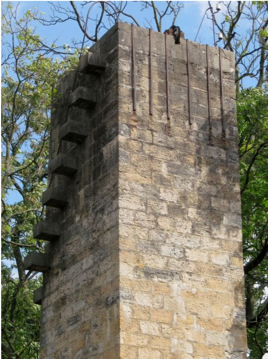
Pile droite, vue partielle : escalier et poulie au sommet (depuis le nord-ouest)
