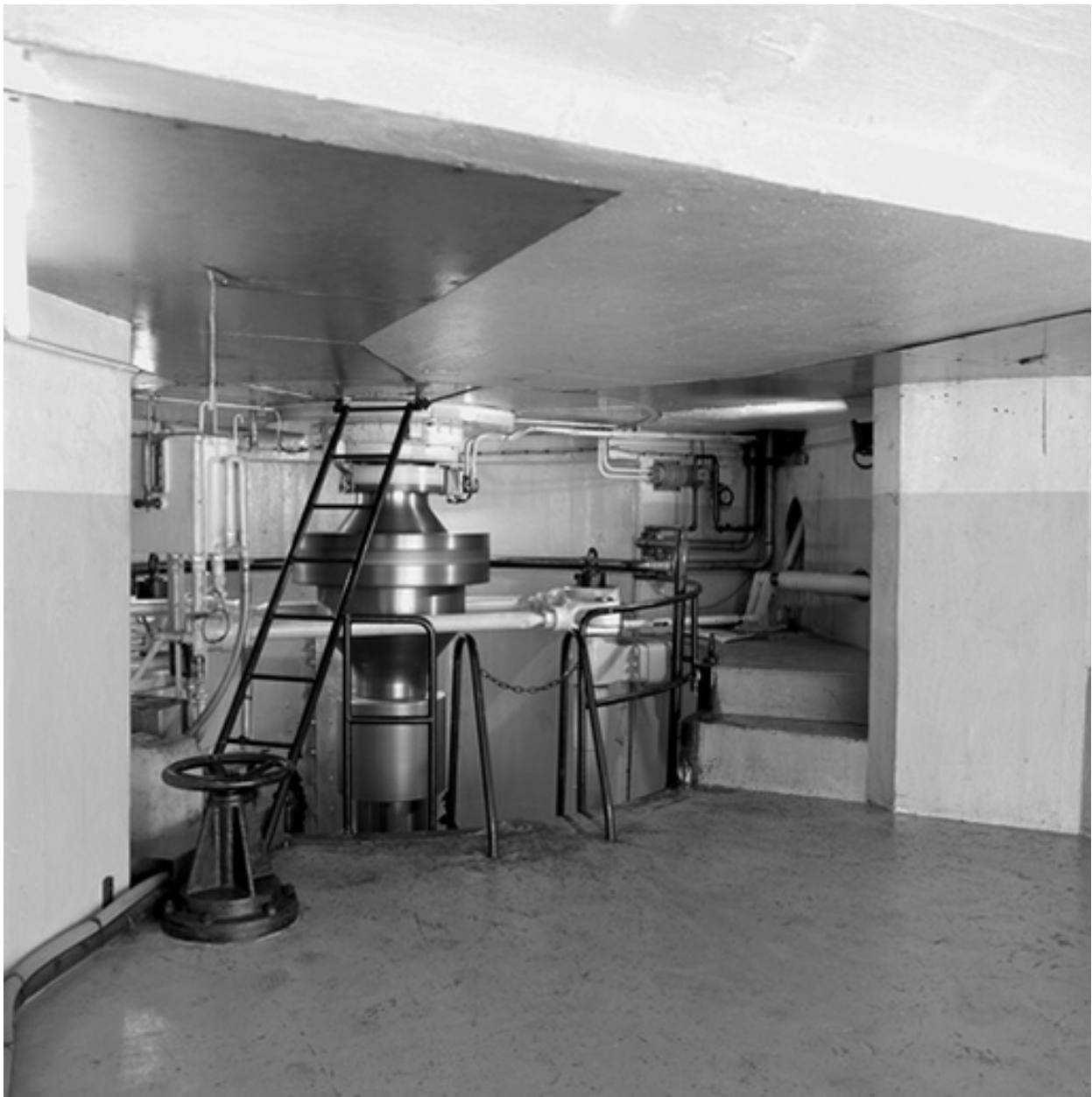
Partie de turbine en sous-sol
