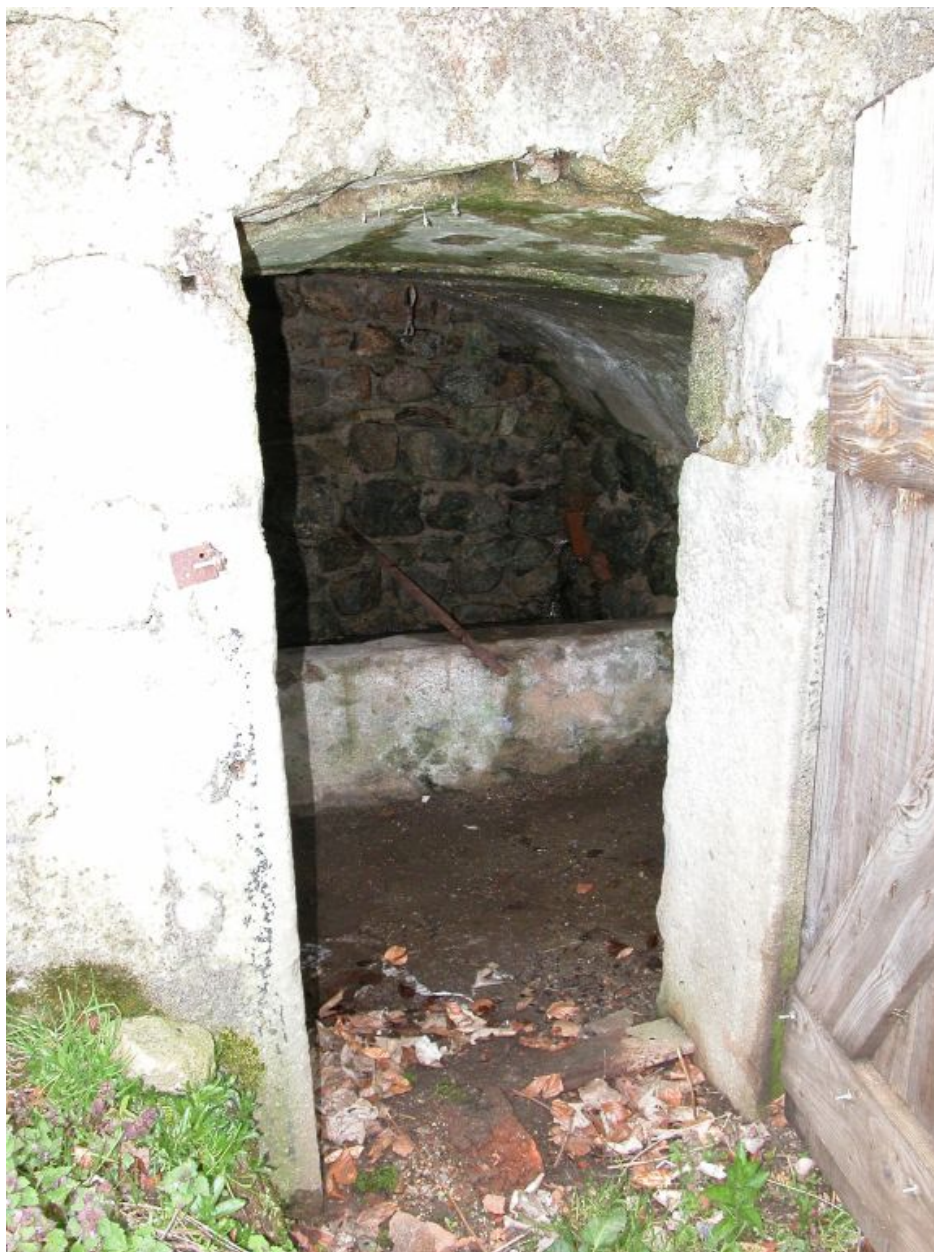
Détail de l'espace réfrigéré.
