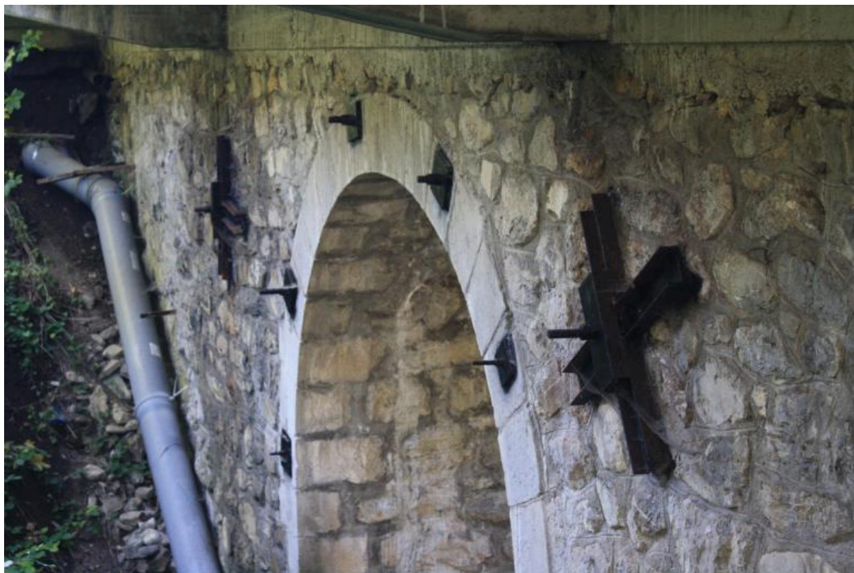
Pont d'Essert-Romand, détails bandeau et tirants d'enserrement
