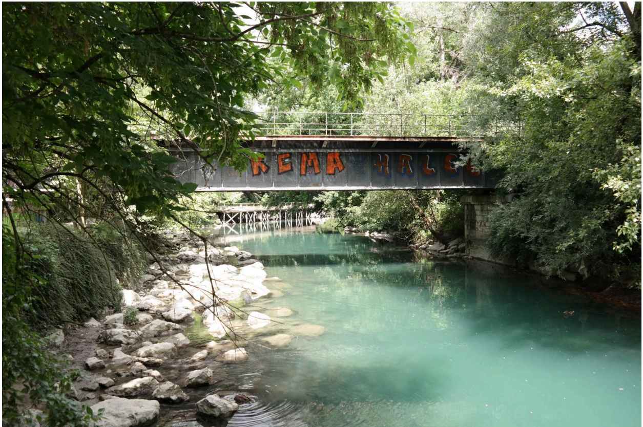
Ancien pont ferroviaire de Cran, vue des tags de la face amont
