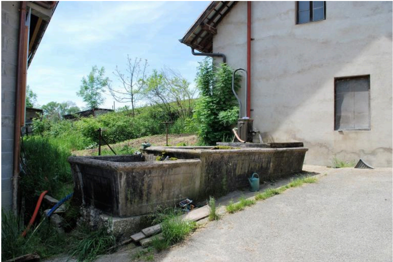
E2 1362, Clos (le), ferme. Vue d'ensemble du bassin datant de 1900.
