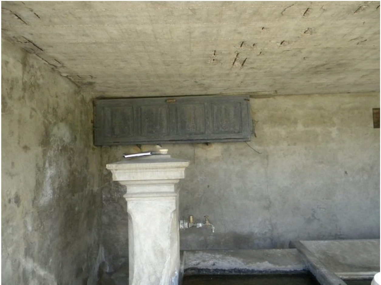
Vue de la borne fontaine et du placard pour le matériel à incendie.
