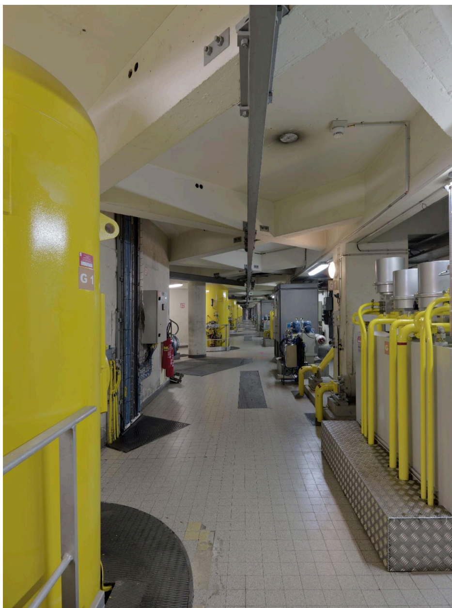
Etage hydraulique ( -2) de la centrale
