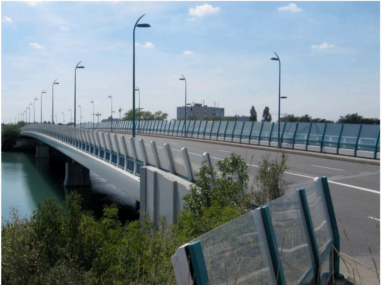
Vue générale, de dessus, chaussée et parapet, face amont (depuis la rive droite)
