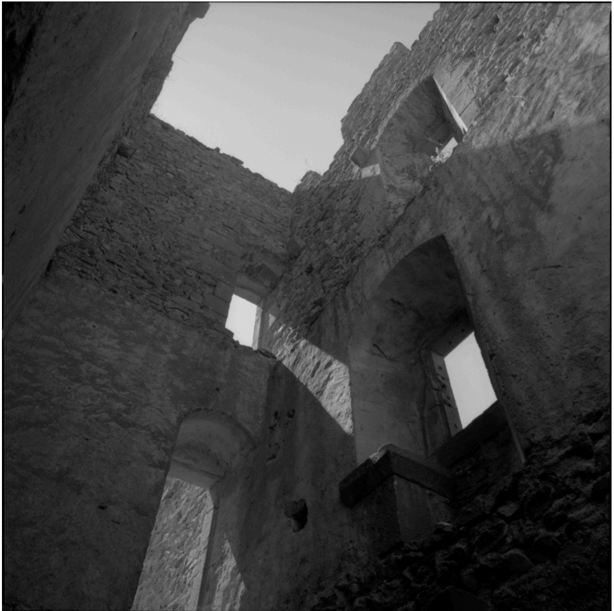
Ouvrage avancé du château fort primitif, tour carrée dite tour des Arrêts : vue en contreplongée des murs nord-ouest et nord-est, du sud.
