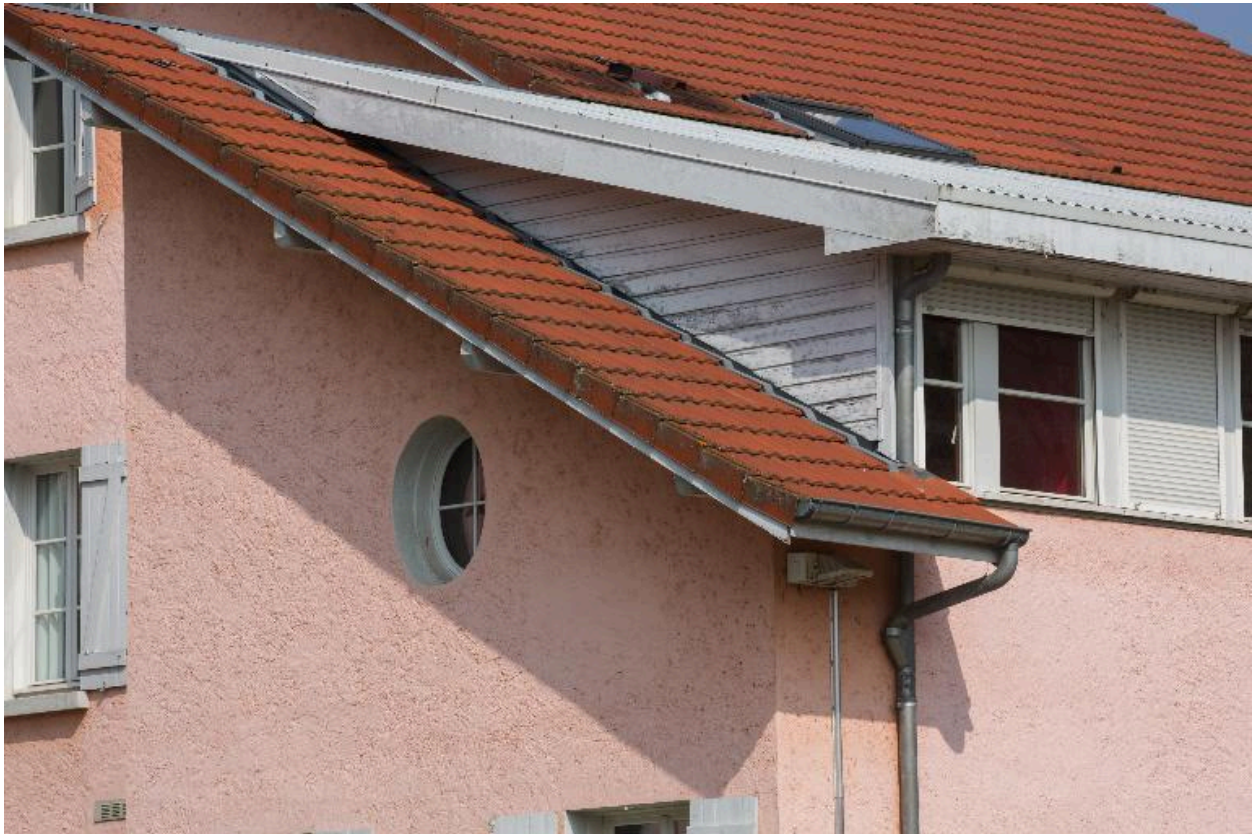
Bât. A : détail avec lucarne de la façade sud-ouest de l'aile est
