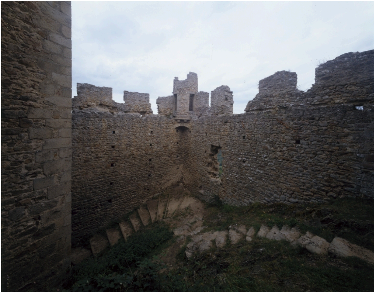
Ouvrage avancé du château fort primitif : vue intérieur des courtines nord-ouest et nord-est et de l'échauguette d'angle, du sud-est.
