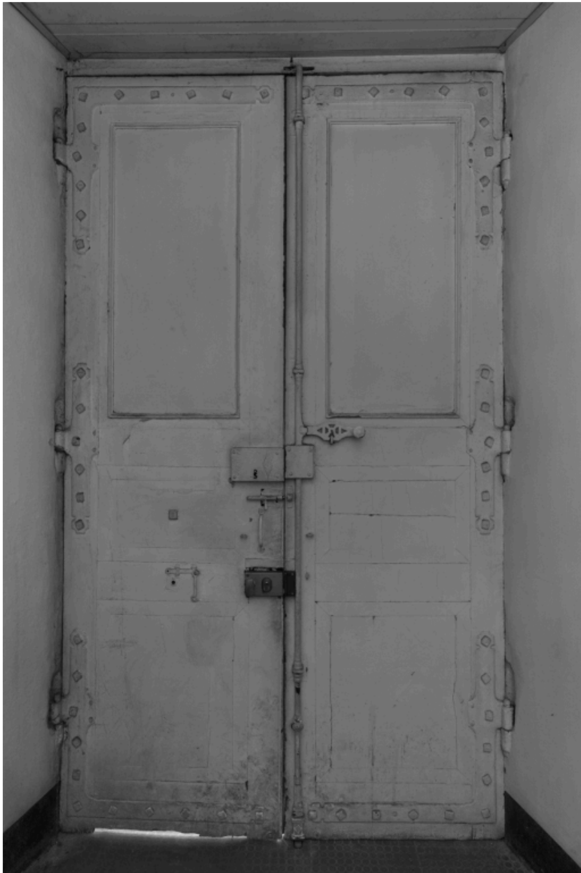
Bâtiment J. Huisserie des portes du rez-de-chaussée
