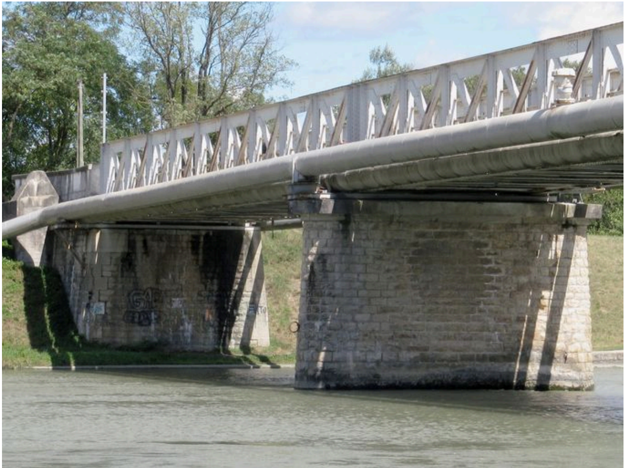
Vue partielle, travée et culée droite, face aval (depuis la rive gauche)
