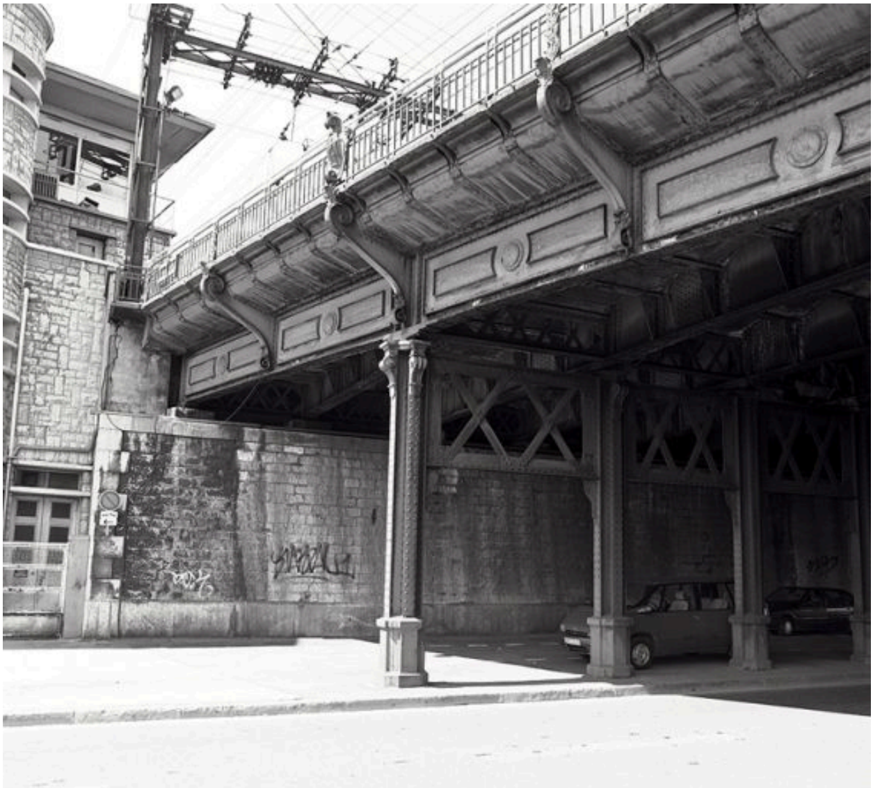
Vue de la travée de rive sur le quai Perrache, depuis le sud-est
