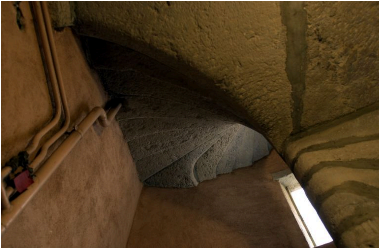
Escalier, raccord au 3e étage entre les marches de la partie ancienne et celles de la partie ajoutée au 18e siècle, vu par dessous
