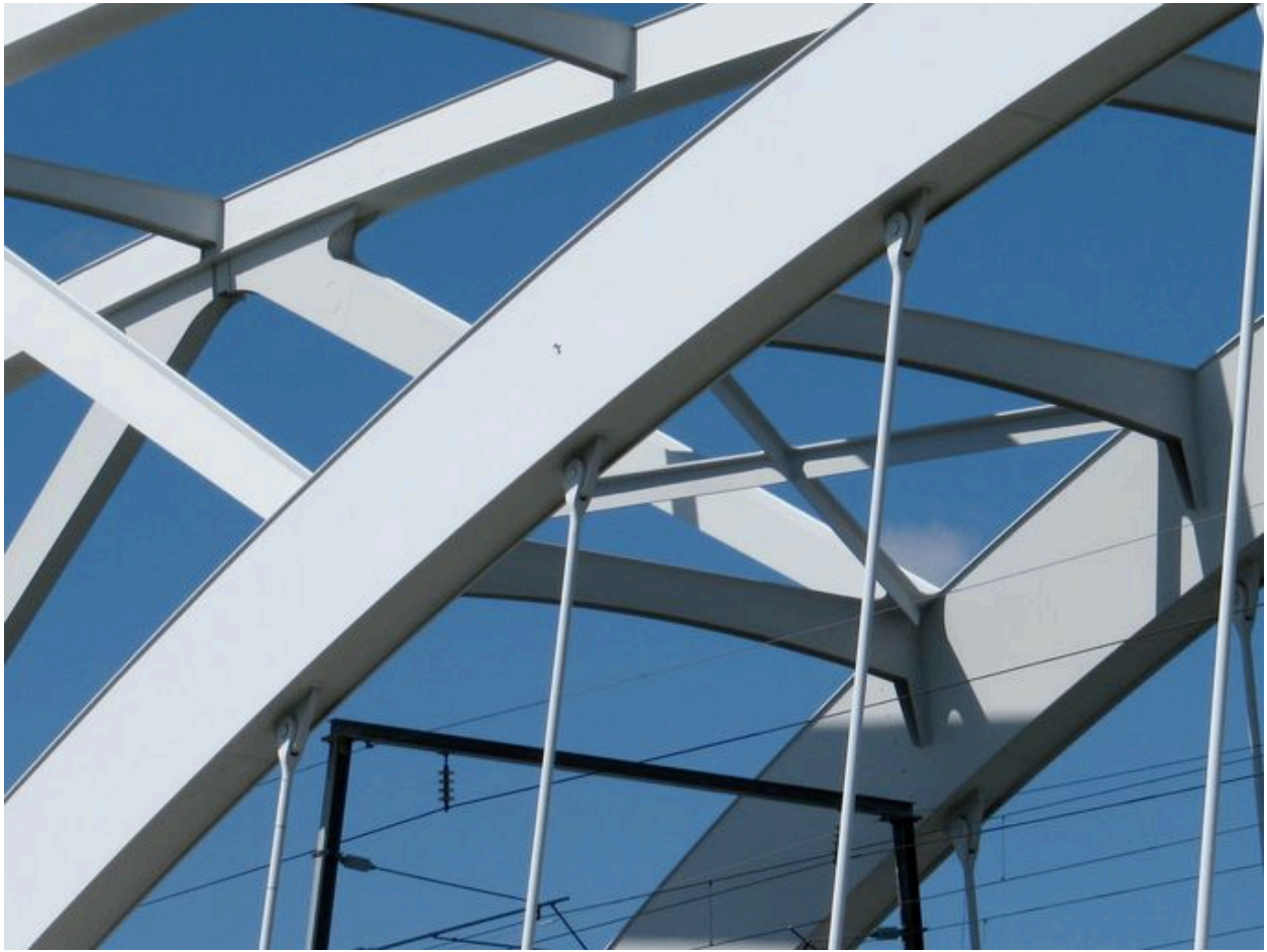
Arc, face aval, vue de détail : jonction avec les suspentes (depuis la rive gauche)
