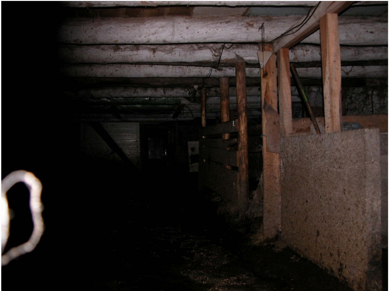
Vue intérieure de l'étable depuis la porte de communication avec la cuisine.
