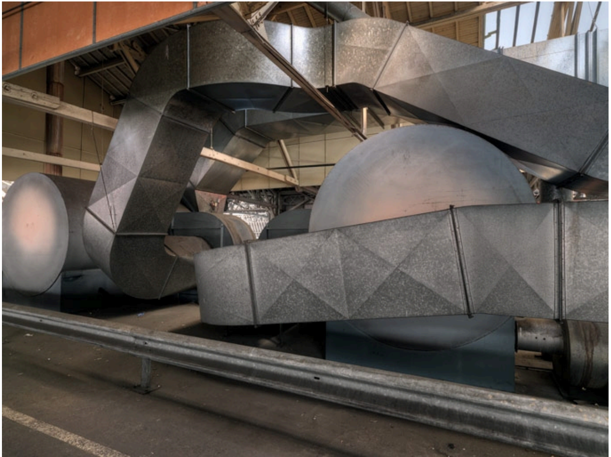
Machinerie de ventilation du garage
