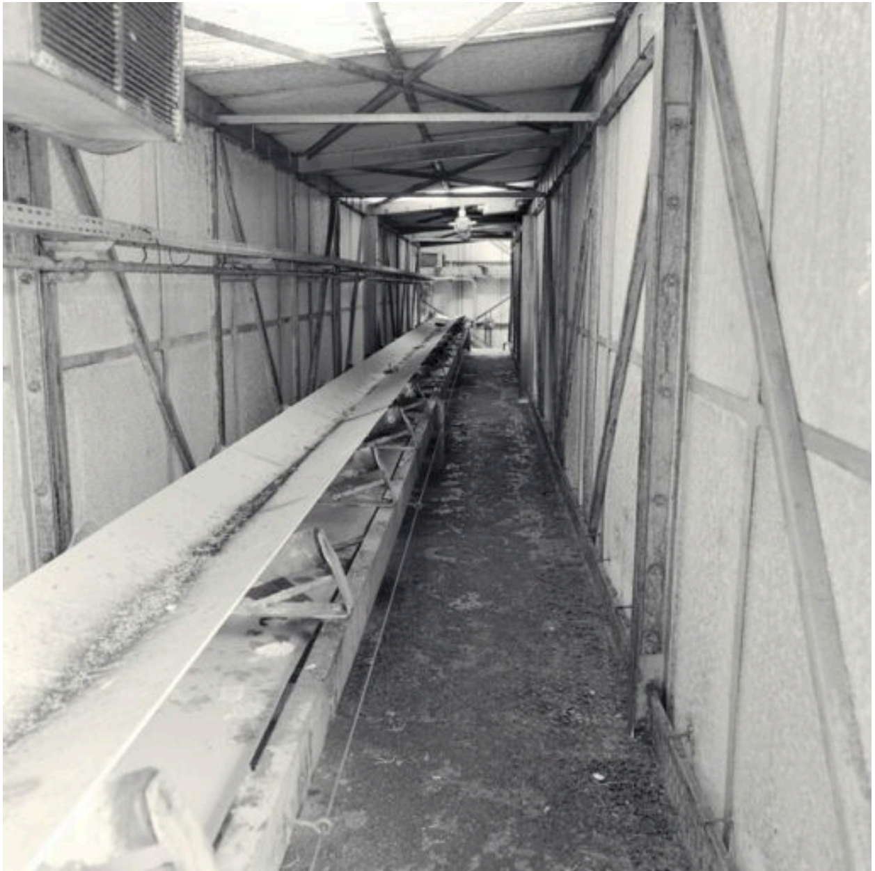
La galerie aérienne entre les silos et les ateliers : vue du transporteur à bandes vers les ateliers
