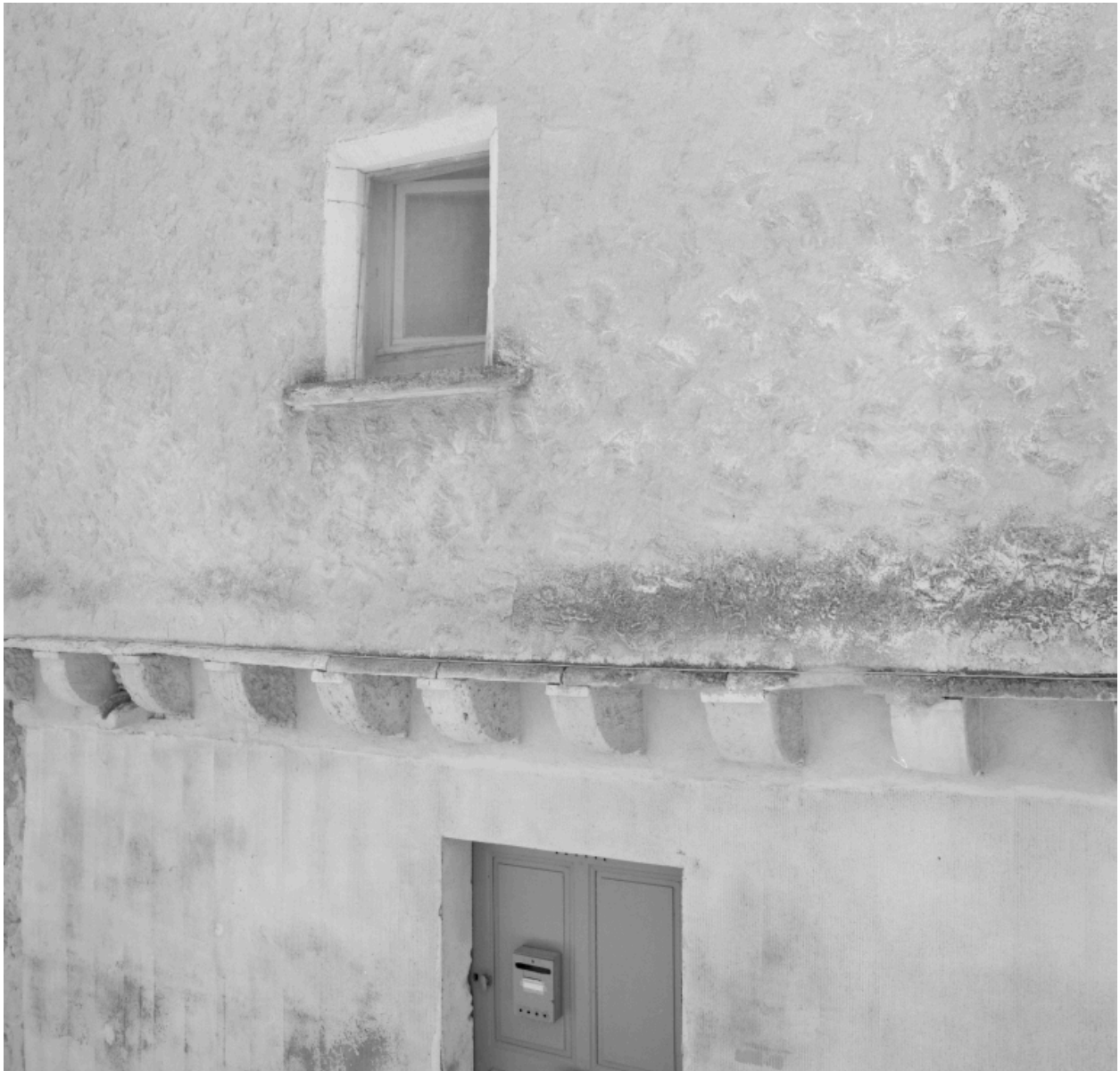
Le Village, rue de l'Eglise. Détail de corbeaux sur une élévation latérale de la maison A2 1076.
