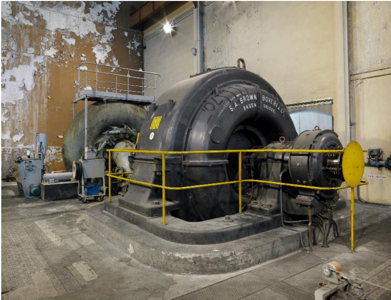
Vue d'un alternateur de la centrale de Livet
