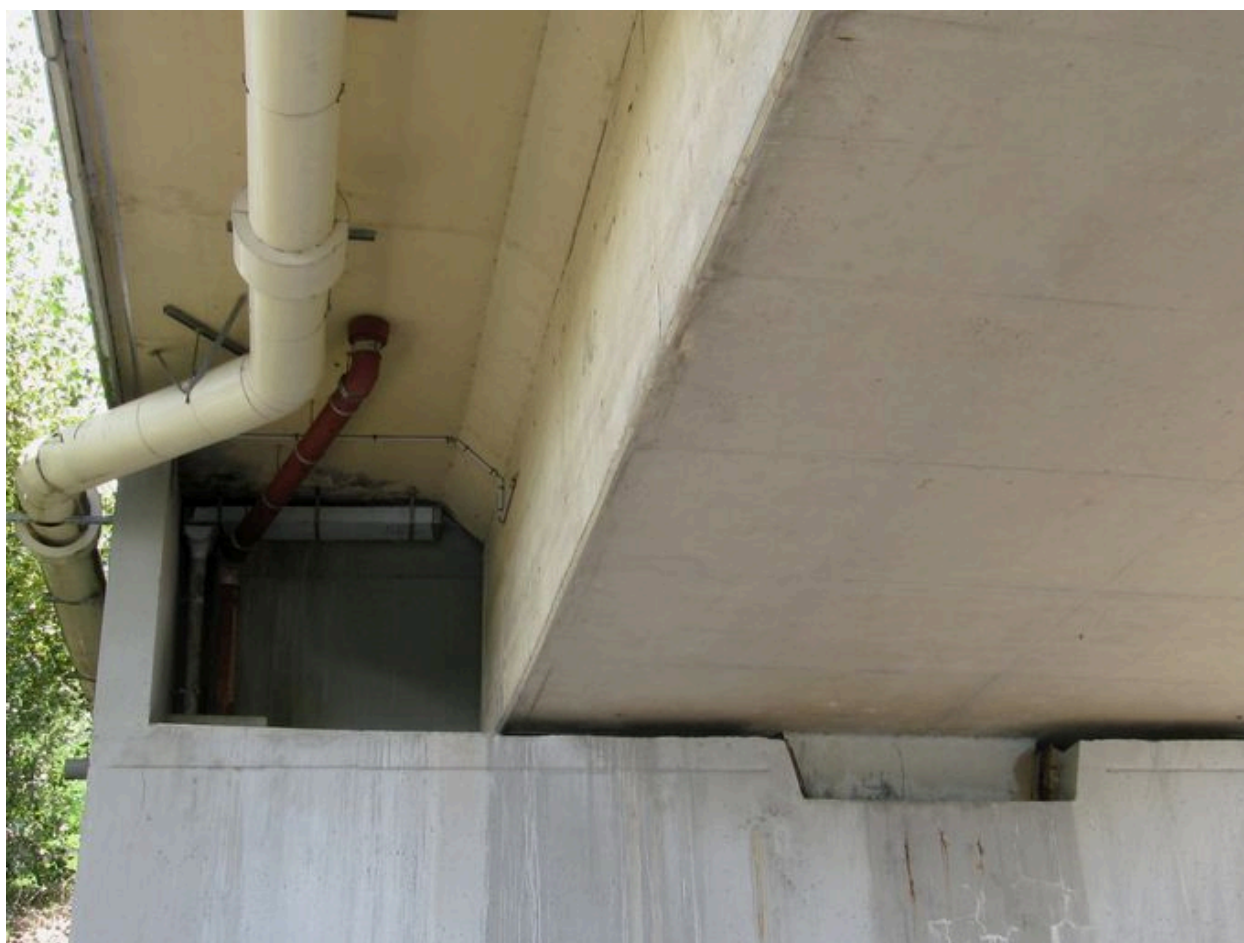
Culée gauche, vue partielle : jonction avec la tablier (depuis la rive gauche)
