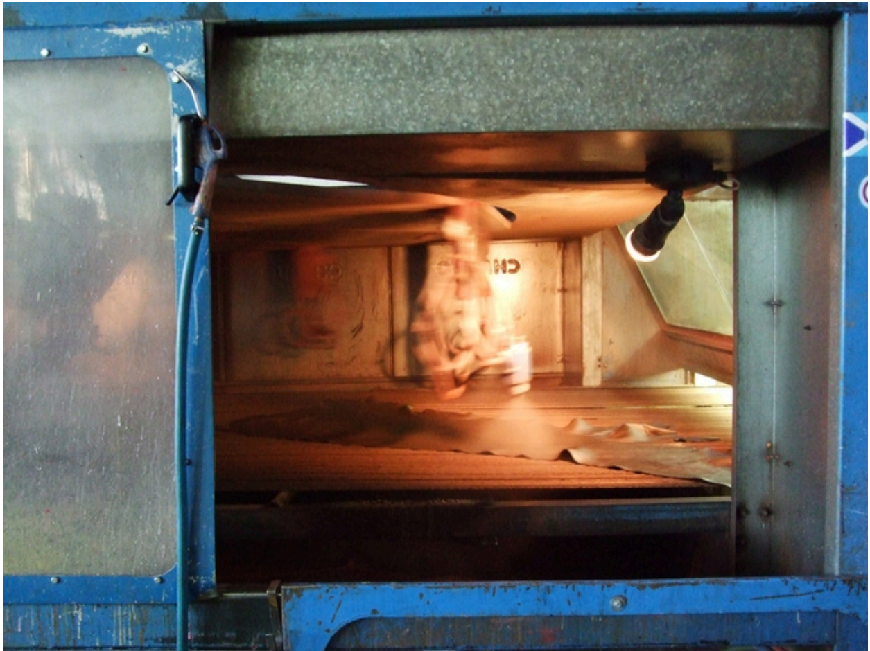
Vue intérieure : machine
