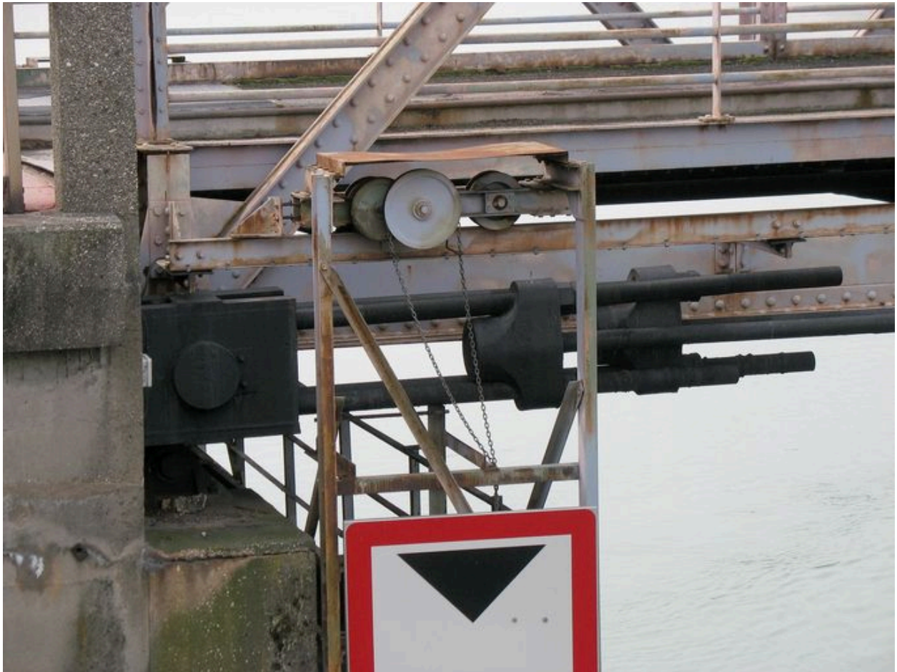
Travée gauche, face amont, vue de détail : ancrage du câble porteur dans la culée, de côté (depuis la rive gauche)
