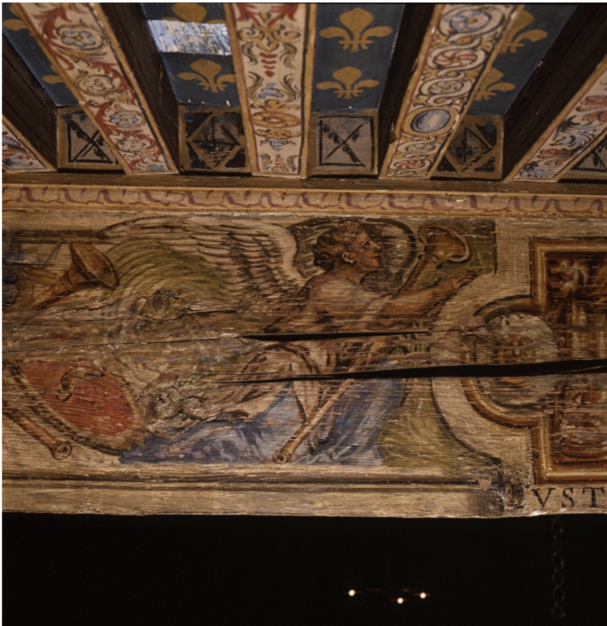
Poutre 5, face sud, centre gauche, support du cartouche : Renommée.
