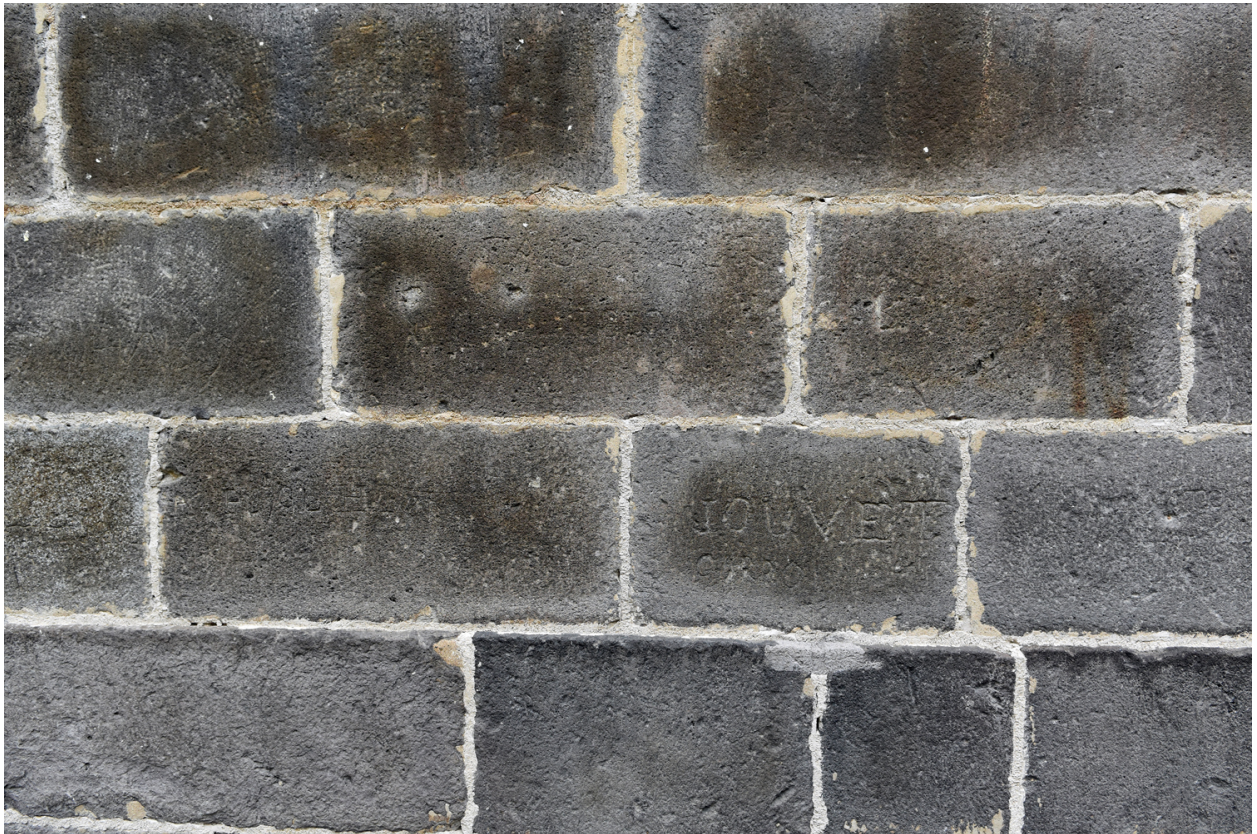
Bâtiment B, élévation sur cour : graffiti
