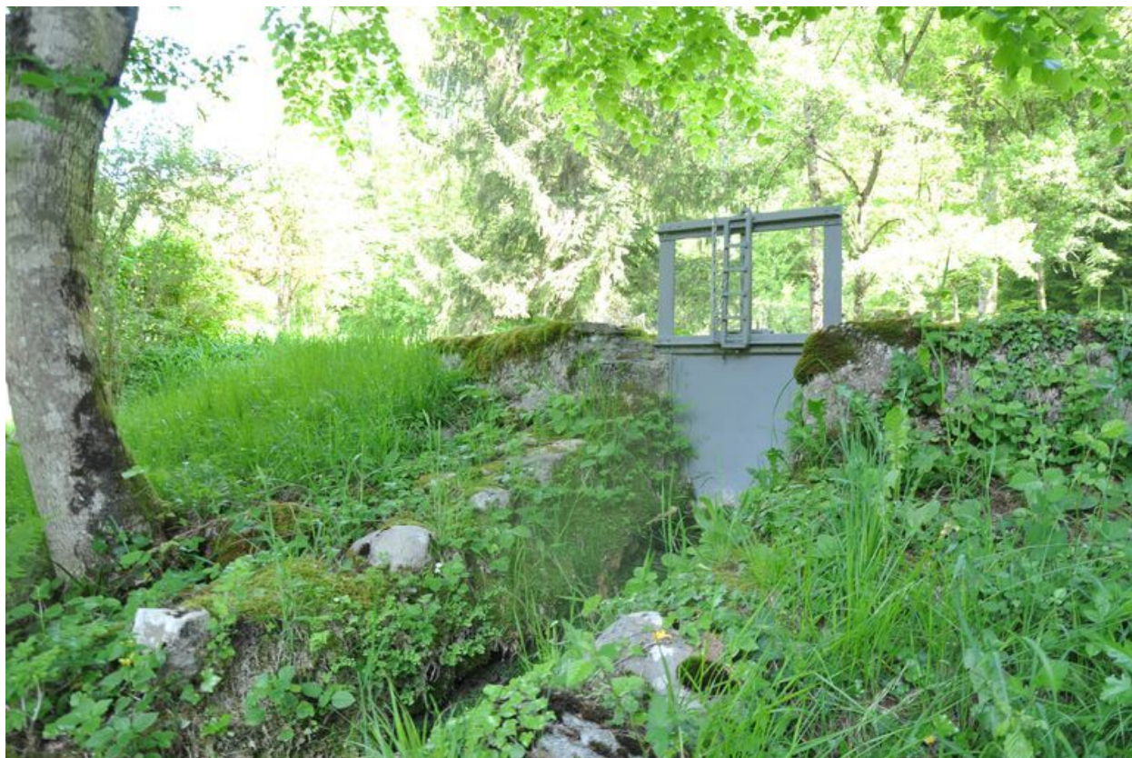
Vanne de régulation du trop plein du bassin
